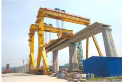
MG T L450提梁机，跨度36米，起升高度40米，应用于中铁十一局京福客专。
